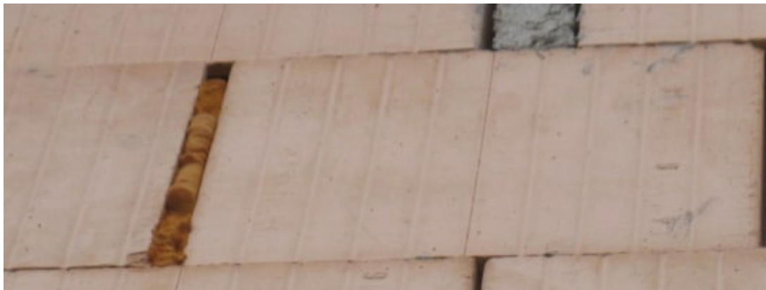
Abb. 5: Nicht fachgerechtes Verschließen der Fugen (Quelle: anonymisierter Sachverständiger)
