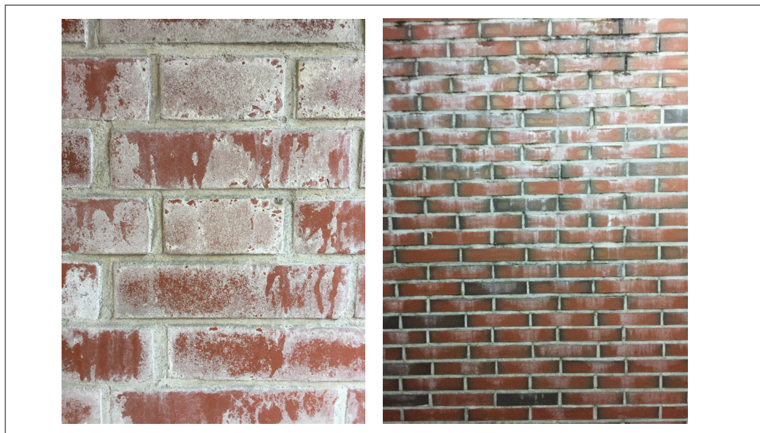
Abb. 11: Ausblühungen (Quelle: eigene Darstellung)
