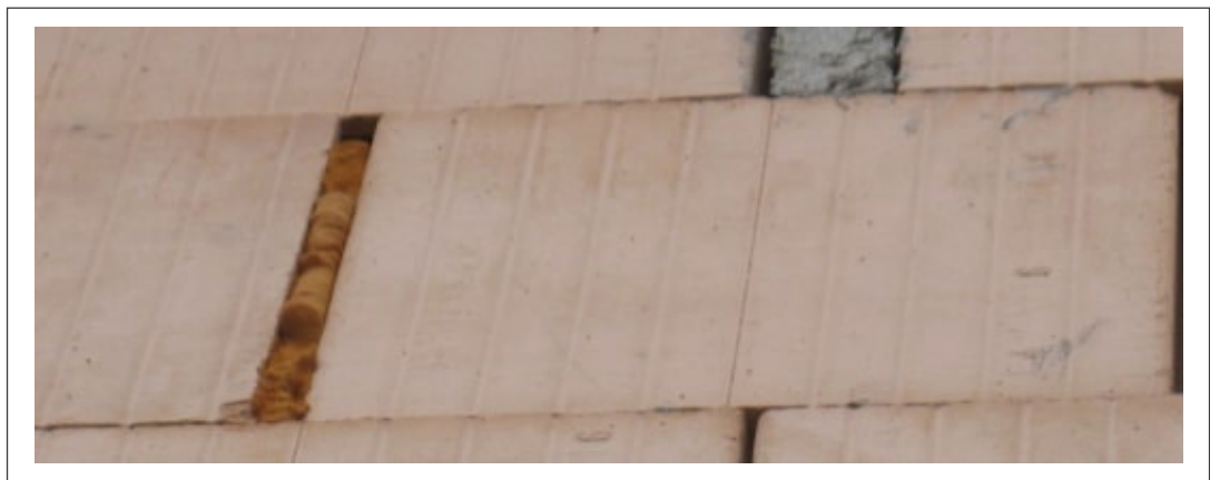
Abb. 5: Nicht fachgerechtes Verschließen der Fugen (Quelle: anonymisierter Sachverständiger)
